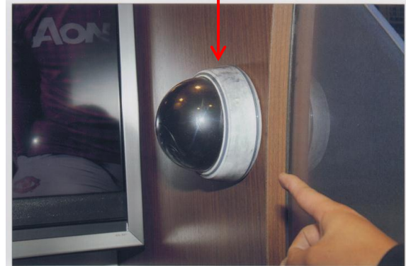
カメラの設置状況
